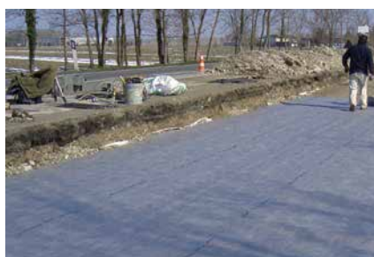
Stesa del filtro separatore
