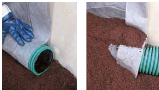
Copertura di protezione delle tubazione di drenaggio
